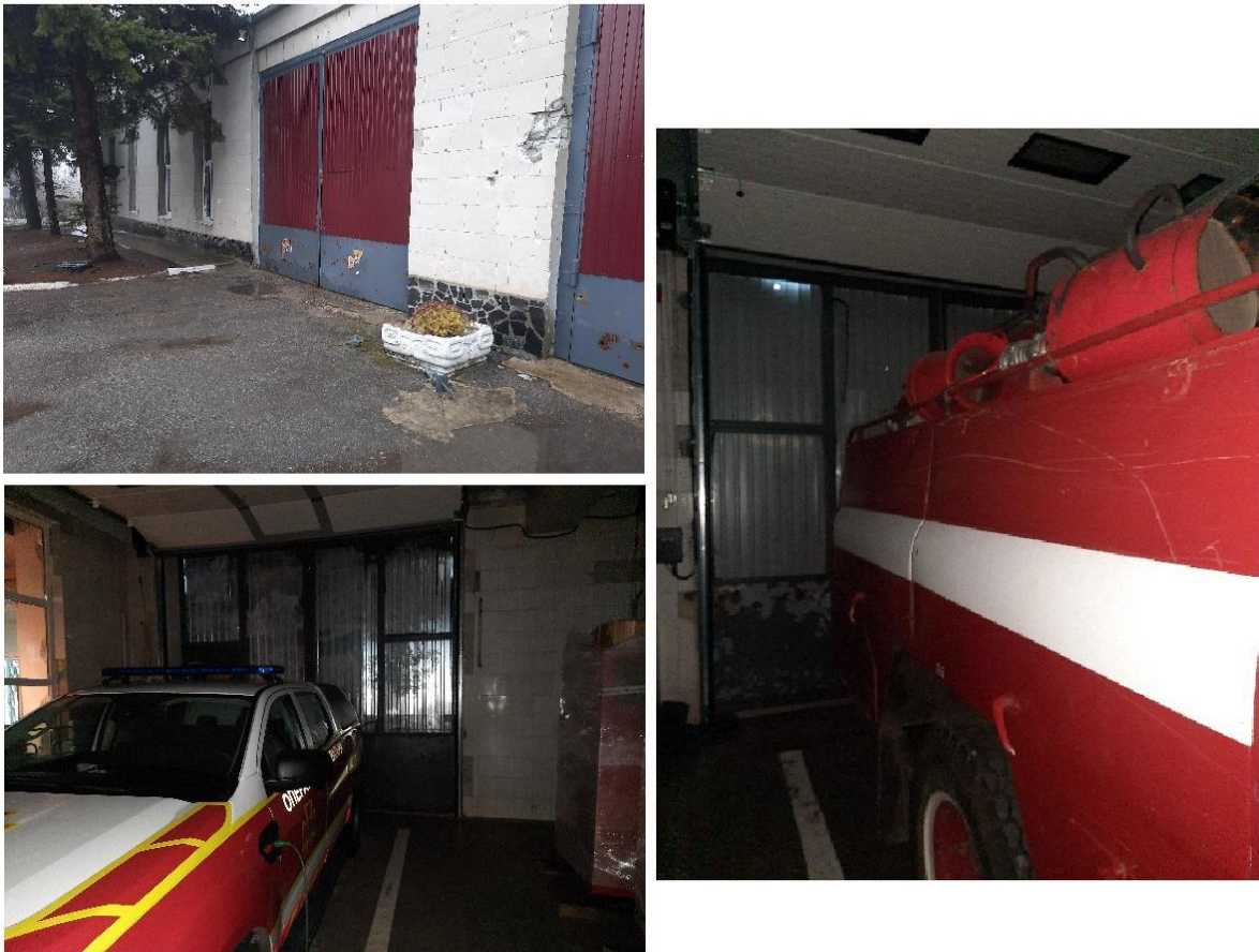
Рисунок 3.2 – Стан воріт після обстрілу прилеглої території (скло замінено профнастилом). Приклади розміщення оперативних транспортних засобів задньою частиною до виїзних воріт
